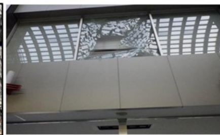
ターミナルビル内ガラス破損
