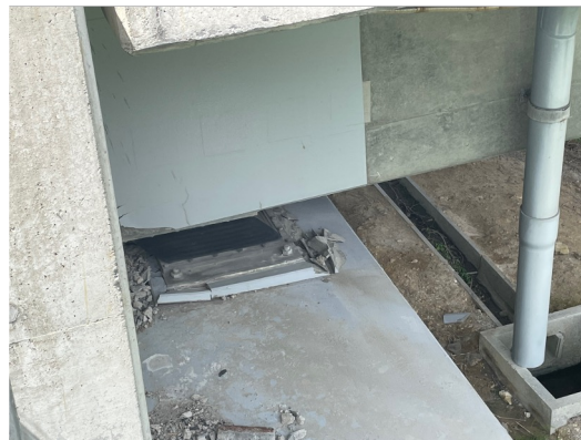
橋脚支承部の 大きな横滑り
